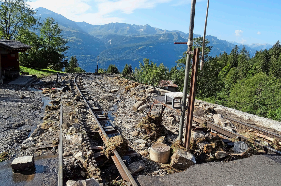
Unmittelbar nach dem Unwetter: Blick auf die verwüsteten Gleise bei der Mittelstation Planalp.
